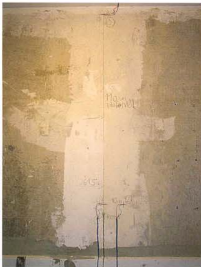
8. ábra: Termoelemek és kondenzáció érzékelő a szigetelés alatt
